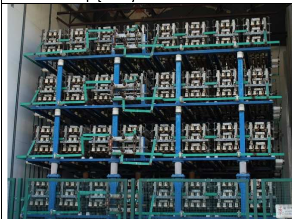
Rys. 3. Opornica zewnętrzna o mocy 2.5 MVA.
