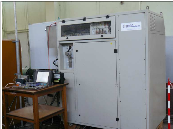
Rys. 1. Stanowisko do badań układów napędowych 3000 V DC.
